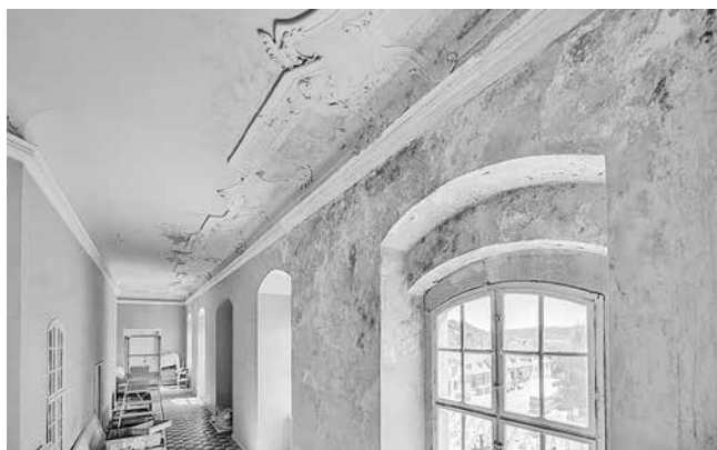
Innenräume im Westflügel mit Feuchteschäden
