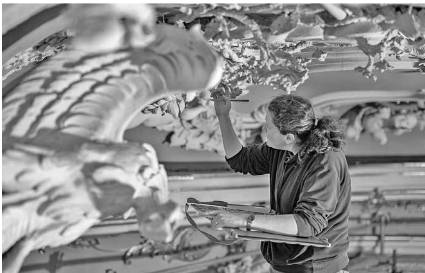
Schadkartierung an der Festsaaldecke
