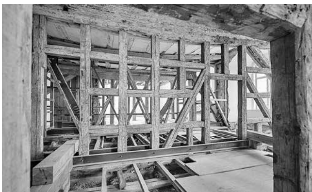
Notgesichertes Fachwerk über dem Ekho-Theater
