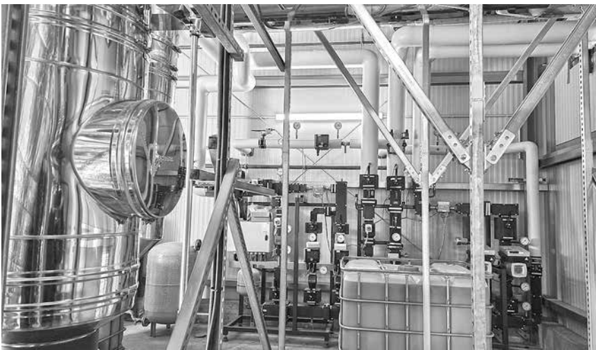
Die Stadt Jena arbeitet daran, Emissionen zu reduzieren. Beispielsweise spart der städtische Eigenbetrieb Kommunalservice Jena mit einer Hackschnitzelanlage seit 2023 jährlich mehr als 155 Tonnen CO 2 ein.
