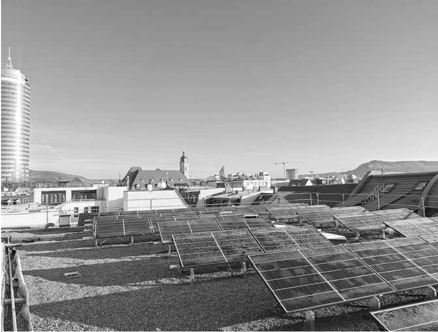
Der Klimaaktionsplan sieht u. a. den verstärkten Einsatz von Photovoltaik-Anlagen vor. Auf dem Bibliotheks- und Bürgerserviceneubau in Jena ist bereits eine PV-Anlage installiert.
