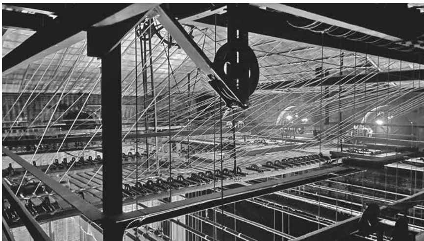
Die Technik des Bühnenturms, die sogenannten Handkonterzüge im Schnürboden, welche u. a. schnelle Bühnenbildwechsel ermöglichten, stammten aus dem Eröffnungsjahr 1917, auch die Elektrik wurde zum Teil seitdem nicht erneuert. Hier herrschte ebenfalls dringender Sanierungsbedarf. Foto: © Anja Daniela Wagner
