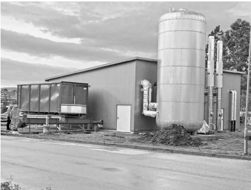
Rückansicht Heizzentrale mit 50.000-l-Pufferspeicher und Schubbodencontainer zur Beschickung Fotos: Kommunalservice Jena
