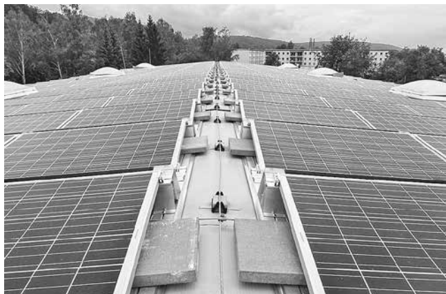
Auf der Staatlichen Regelschule „J. W. Heimbürge“ in Kahla wurde eine Photovoltaikanlage errichtet. Die 73-kWp-Anlage gehörte zu den ersten auf Schulen im Saale-Holzland-Kreis und wurde gemeinsam mit der BürgerEnergie Saale-Holzland errichtet. Die Schule wurde im Landesprojekt „10 Grüne Schulhöfe für Thüringen“ gefördert und 2021 mit dem 1. Platz beim „Förderpreis für zukunftsweisende Projekte von Schülerinnen und Schülern“ des Saale-Holzland-Kreises ausgezeichnet. Foto: BürgerEnergie eG
