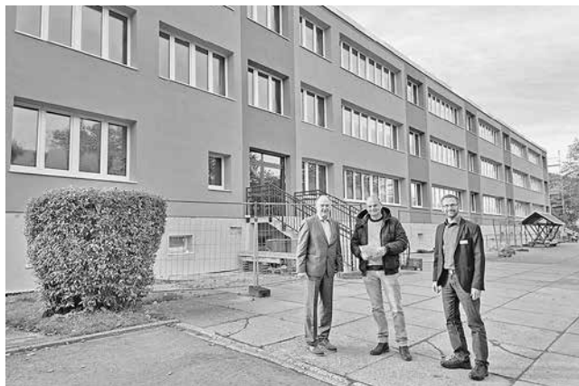
An der Grundschule „Tälerschule“ in Ottendorf laufen umfangreiche energetische Sanierungsarbeiten; u. a. wurden die Fenster erneuert, Sonnenschutz angebracht und das Gebäude gedämmt. Mehr als eine Million Euro hat der Saale-Holzland-Kreis dafür in diesem Jahr bereits investiert; 2023 sind 400.000 Euro für den Einbau einer Pelletheizung geplant. Im Bild Landrat Andreas Heller (li.), Abteilungsleiter Frank Pucklitsch (re.) und der zuständige Amtsleiter Steffen Grosch beim jüngsten Baustellenbesuch. Foto: LRA
