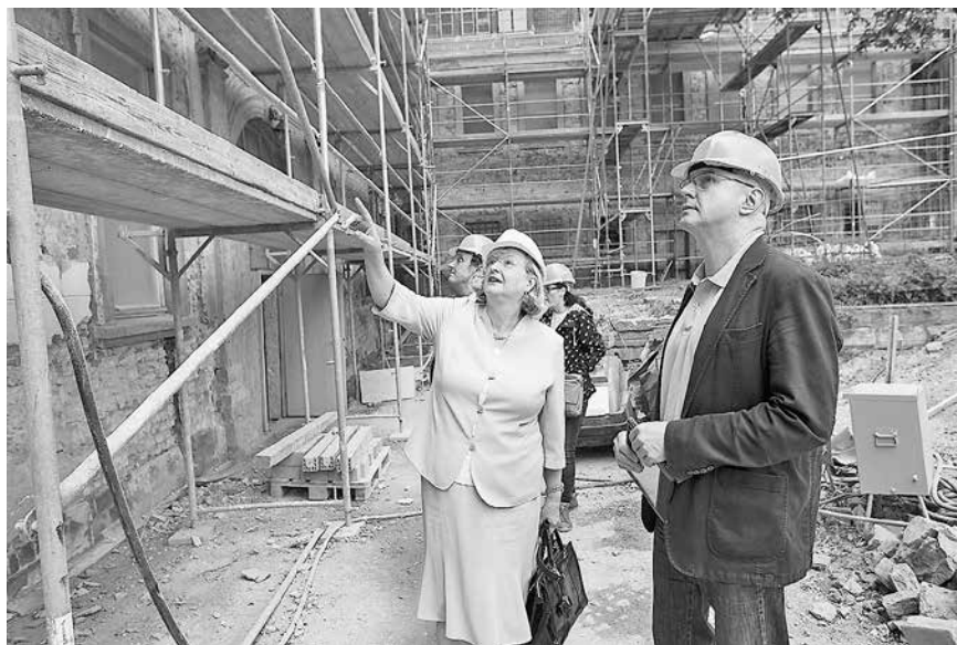
Das Reußische Regierungsgebäude soll künftig Teil des neuen Campus des Goethegymnasiums werden. Oberbürgermeisterin Dr. Viola Hahn mit Fachdienstleiter Hochbau Sven-Gunnar Diener bei der Besichtigung der Baustelle Foto: SV/Steffen Weiß
