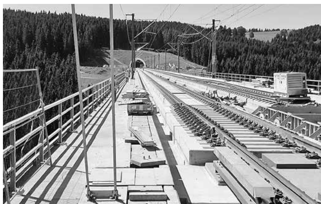
Blick über die Massetalbrücke aus Richtung Tunnel Masserberg in Richtung Tunnel Fleckberg Foto: Martin Modes
