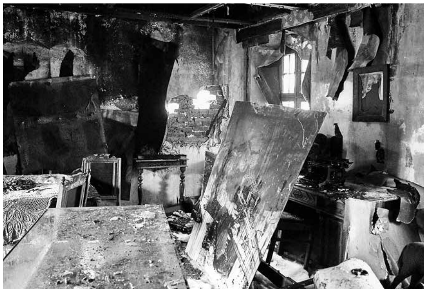
Ein erster Blick in die abgebrannten Gebäudeteile offenbarte das große Ausmaß der Zerstörungen Fotos: Manfred Ständer
