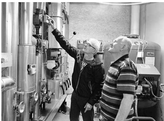
Jürgen Patschull und Frank Köcher (v. li.) kontrollieren die Pumpe für die Hackschnitzeltrocknung Foto OTZ/Michael Graf
