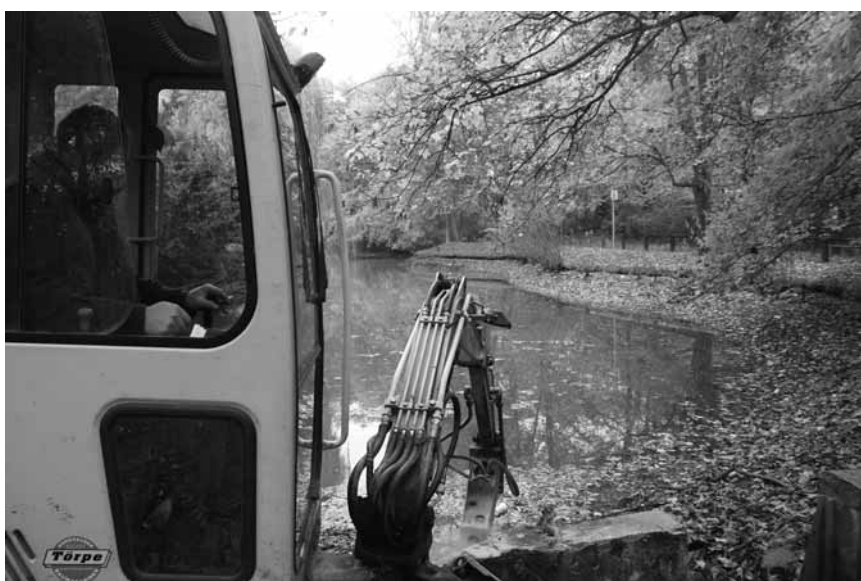
Im Nordhäuser Stadtpark laufen die Arbeiten zur Neugestaltung auf vollen Touren. Hier wird der Zulauf zum Ententeich erneuert.
