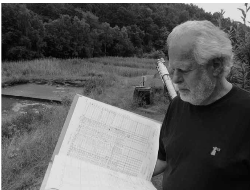
Bürgermeister Grobe mit dem Kontrollbuch vor der Wurzelraumkläranlage seiner Gemeinde Petersdorf: „Ein Perpetuum mobile – fast“
